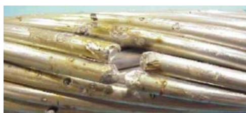
Рис. 2. Разрушение двух проволок оптического грозотроса в результате прямого удара молнии [8]
